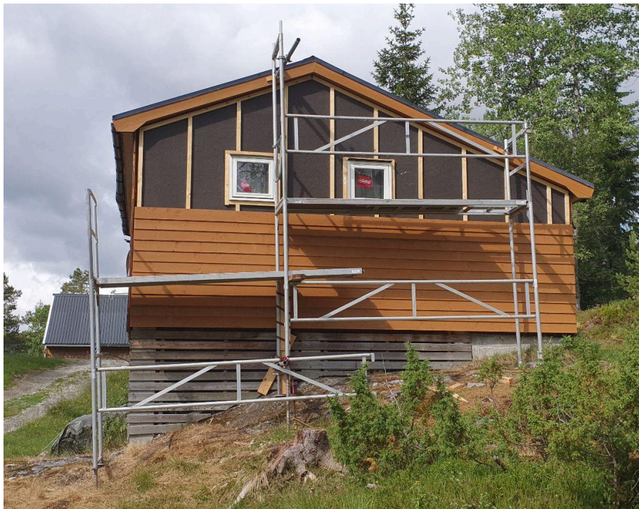
Endevegg på Hytte-3 på Oppheim fikk nye vinduer, ny isolasjon og nytt panel.
